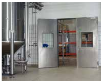
Feuerschutztür, marmorierte Oberfläche, in einem Brauereibetrieb.
