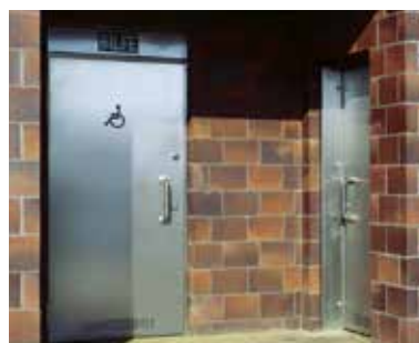
Öffentliche WC-Anlage auf einem Rastplatz.
