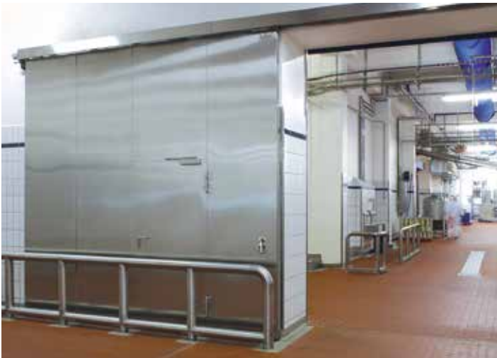
T30 Feuerschutz-Schiebetor, mit Schlupftür, in der Lebensmittelproduktion.
