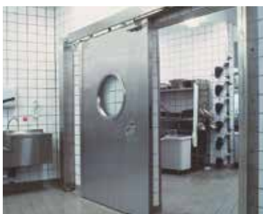
Feuerschutz-Schiebetor in einer Großküche.
